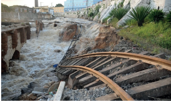
Figura 1: Transbordamento do Rio Mundaú e destruição da infraestrutura em Rio Largo, Al, 2010.
